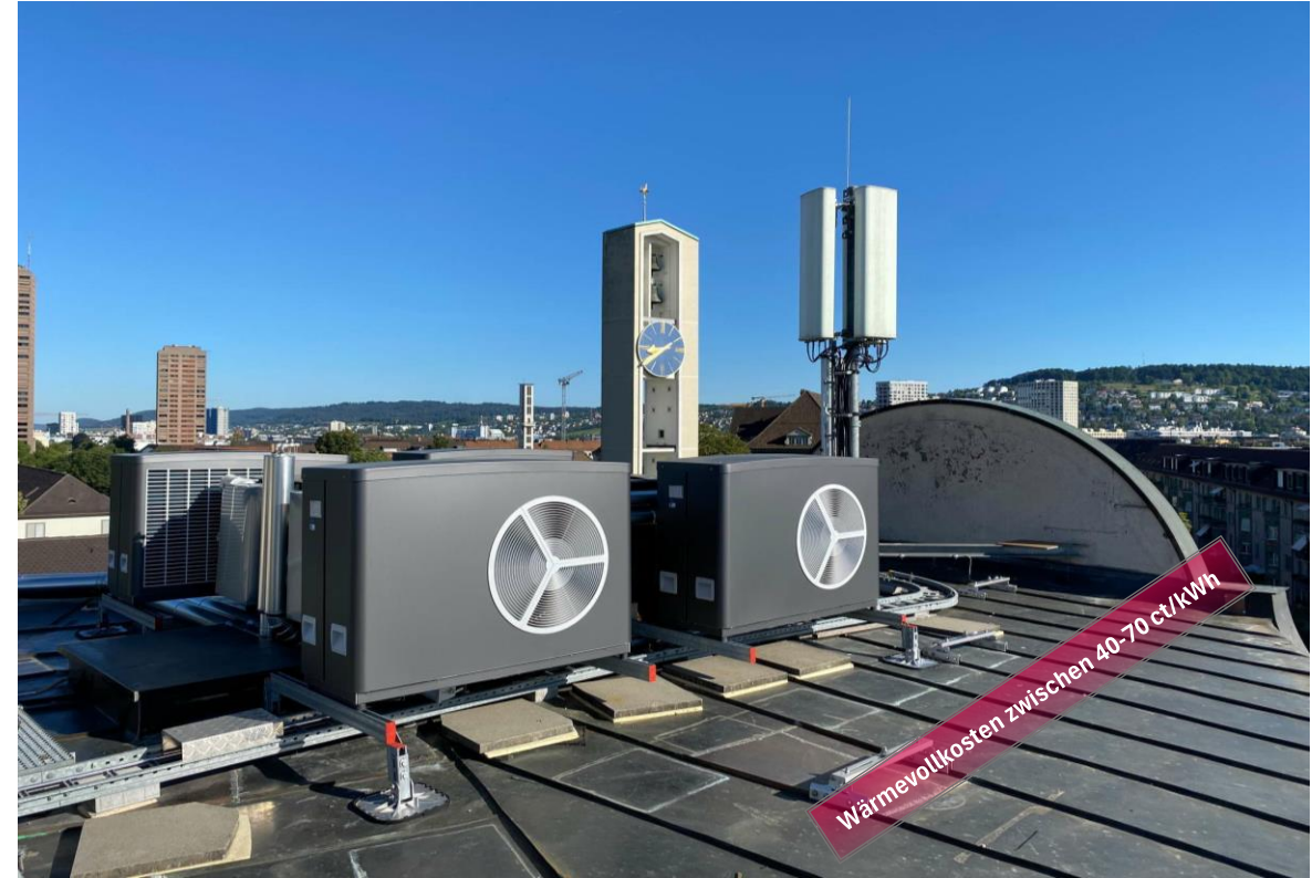
Dezentrale Wärmepumpen-Kaskade auf Flachdach
