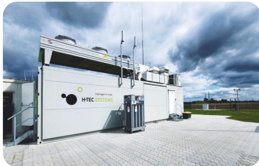
Mobile Anlagen zur dezentralen H 2 -Erzeugung
